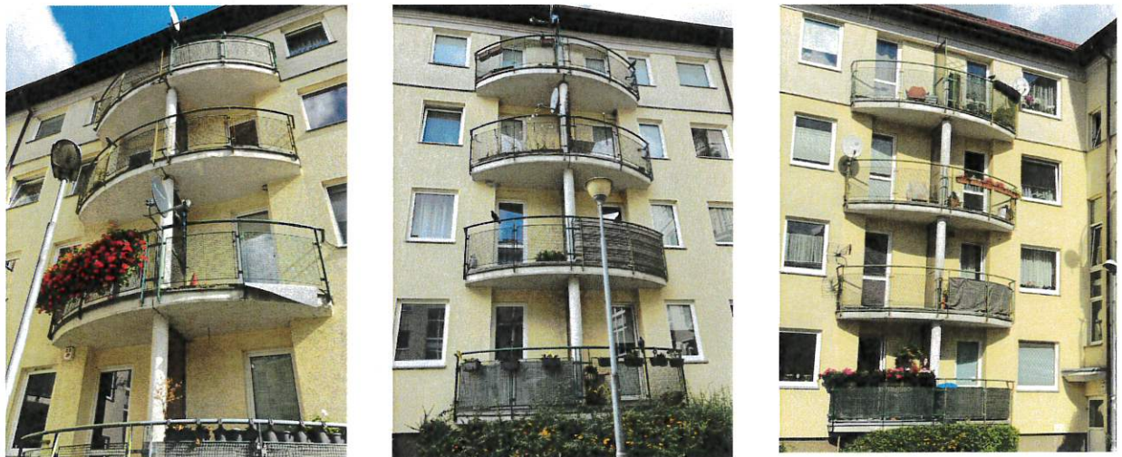
Zdj. 7, 8, 9 – Zdjęcia przedstawiające balkony z przechodzącymi przez nie dylatacjami budynków znajdujące się odpowiednio między klatkami: 40B/42, 44/44A, 40/42A
