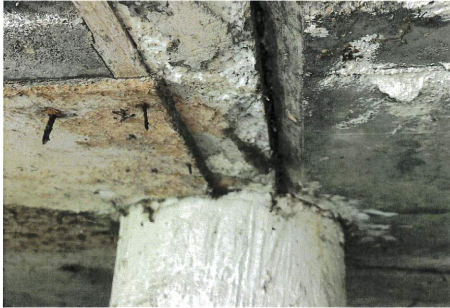
Zdj. 10 – Zdjęcie przedstawiające balkon parteru między klatkami 40B/42 ze słupem okrągłym podczas wizji lokalnej z 28.09.2020r. – widoczna dylatacja prawej płyty balkonowej od słupa oraz płyt względem siebie oraz pozostałości szalunku z budowy (po lewej stronie słupa)
